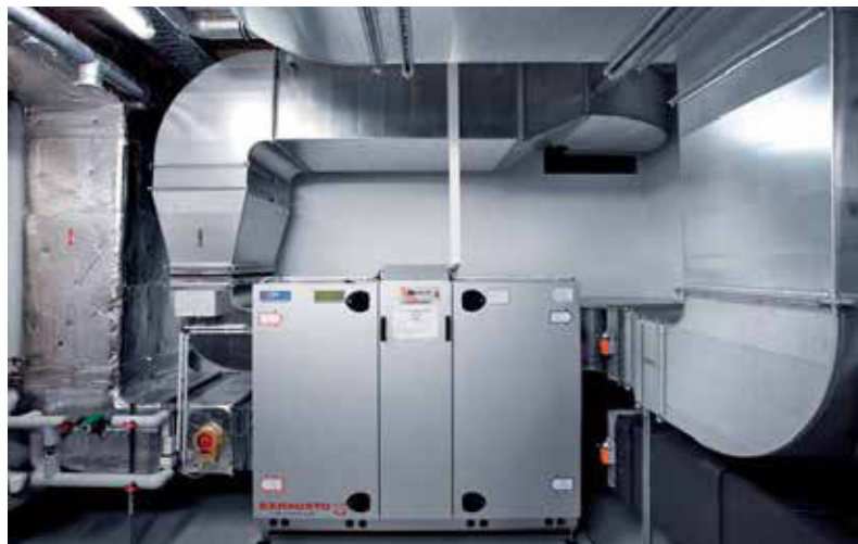
Blick in den Technikraum: die Lüftungsanlage mit Wärmerückgewinnung.
